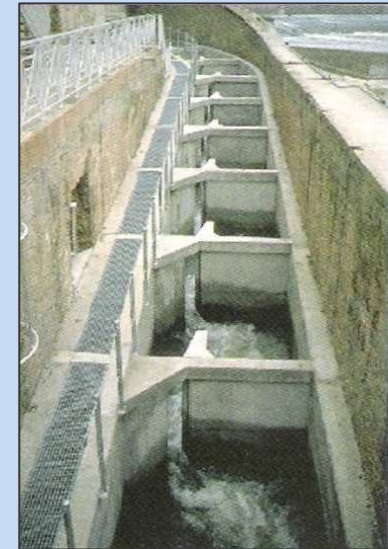
Foto 5: Scala con fessura verticale (Francia-Garonna).
